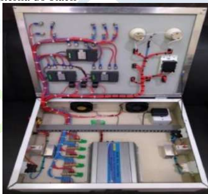
Figura 1.11: Vista Panorâmica Interna do Rack
