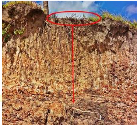
Figura 20. Erosão da parte superior da margem. A seta indica o ponto da queda do arbusto.
